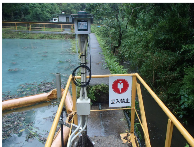
写真5.1.8.3 放流水用pH計の設置状態
