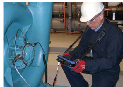
写真5.2.3.1 ポータブル振動計による振動監視
