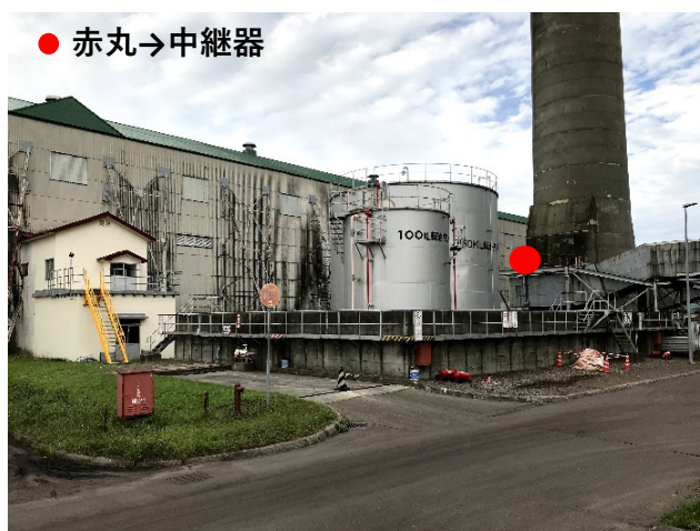
写真5.3.3.1 奥の建屋が屋内貯炭場 右側煙突下部に中継器を設置
