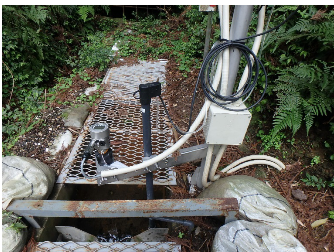
写真5.1.8.2 原水流量のpH検出器とレベル計の設置状態
