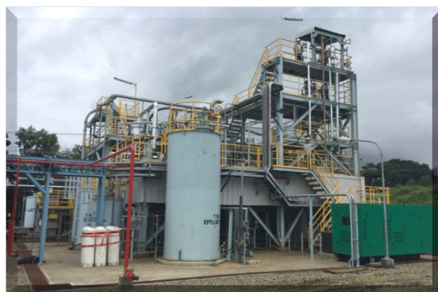
写真4.2.4.1 バイオエタノール実証プラント主要設備前景
