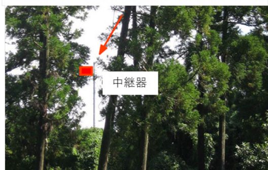
写真5.1.8.1 中継器設置場所
