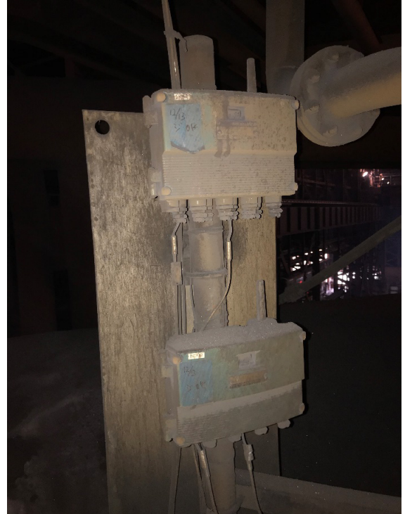
写真5.1.5.1 多点温度伝送器（YTMX580）の現場設置状況 （3年ほど使用しているが問題なし）
